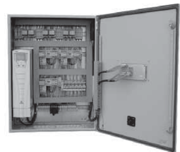
CUADRO CON VARIADOR DE FRECUENCIA
