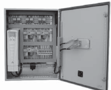
CUADRO CON VARIADOR DE FRECUENCIA
